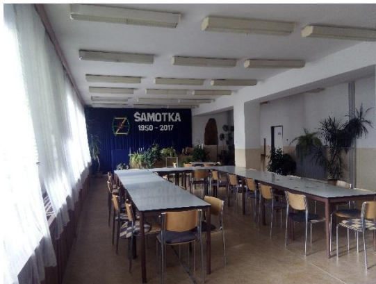
Existujúce žiarivkové osvetľovacie telesá
